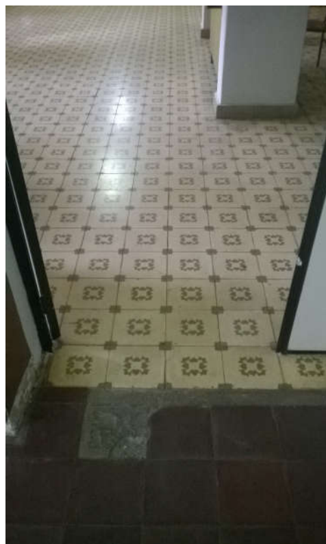
IMAGEM 09 – Piso danificado - Acesso a Biblioteca. Fonte: Edinei Barros 20/01/2016.
