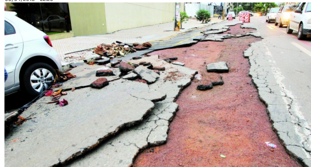
Placas de asfalto se soltaram na Avenida Portugal, no cruzamento com a Alameda das Rosas, no Setor Oeste (Foto: Sebastião Nogueira)
