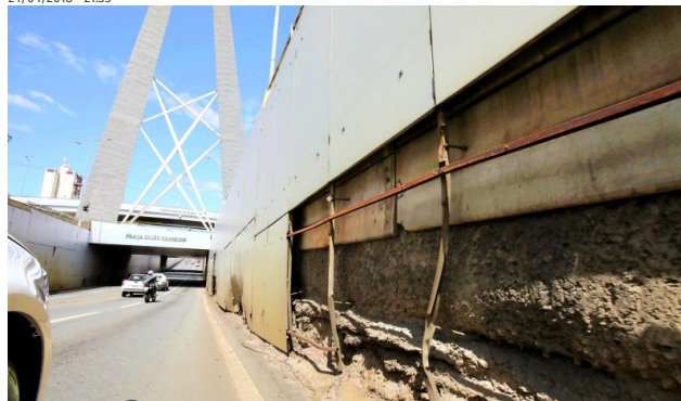
Ausência de placas no viaduto da Avenida 85 com a T-63, criou um vão, com metais retorcidos, expostos às intempéries (Foto: Diomício Gomes)
